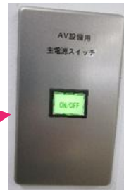
画像 5 AV 設備用主電源スイッチ
