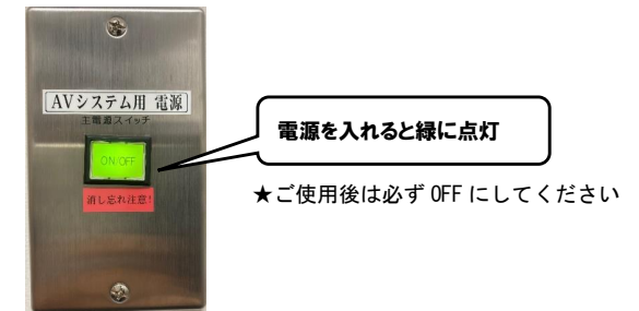
21KOMCEE West・East 各教室壁のAV設備用主電源スイッチ
