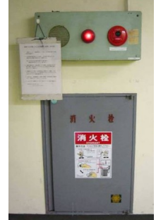
火災報知器と消火栓
