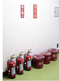
消火器は廊下に設置されている（部屋の中にある場合もある）
