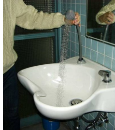
緊急シャワー（トイレに設置）
