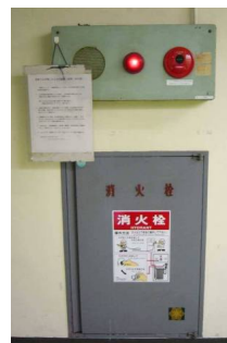
火災報知器と消火栓
